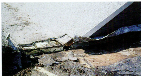
Schade aan het dak. Hier is de boommier bezig geweest.
